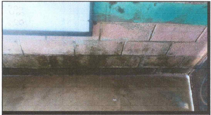
Foto 2: Se observa las necesidades de pintar las paredes interiores y exteriores de cada una de las aulas.
