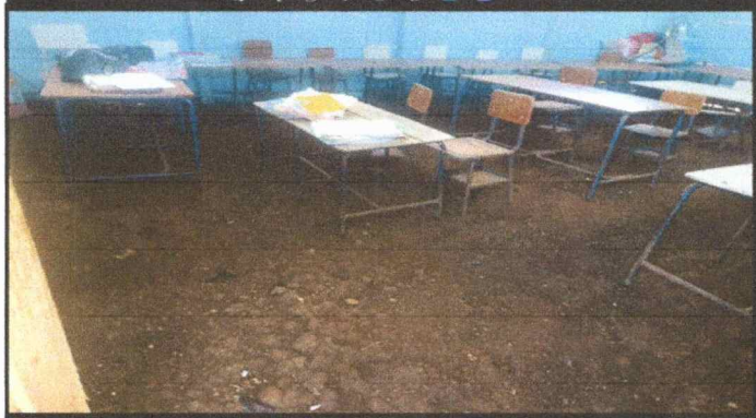
Foto 1: Se observa la necesidad del piso de torta donde se usará los metros de arenas en dos aulas.
