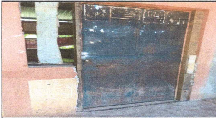
Foto 3: Se observa los daños que tiene las puertas
